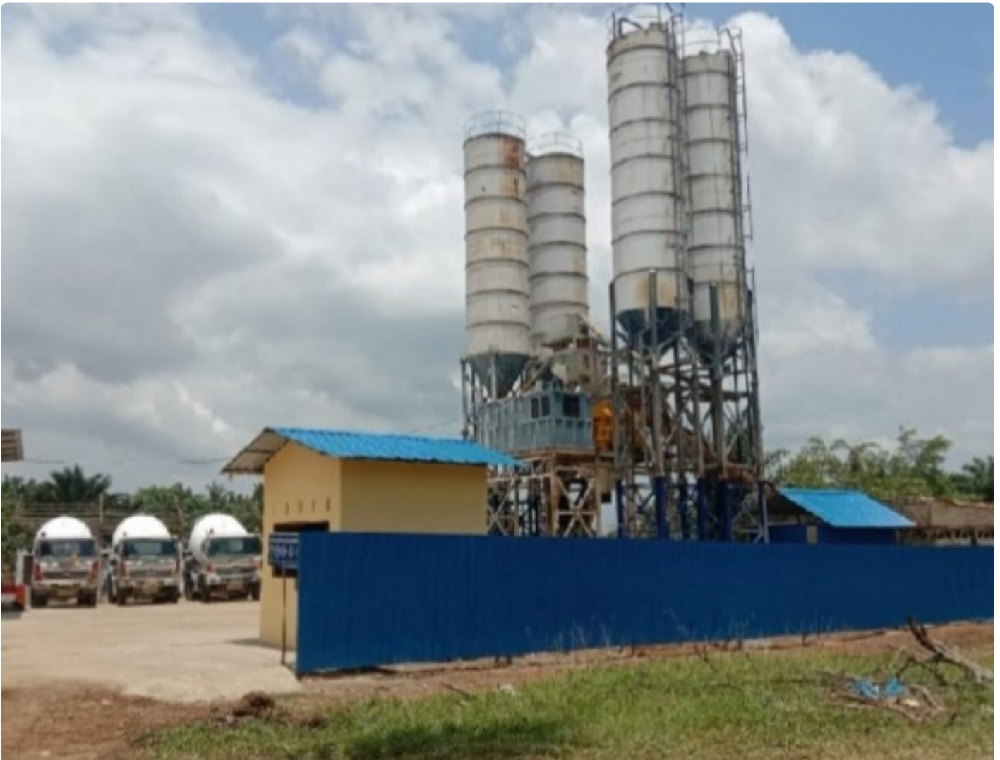
Batching Plant, Pengolahan Cor Beton Milik Rekanan PT PP di Nagori Huta Parik, Kecamatan Ujung Padang, Kabupaten Simalungun
